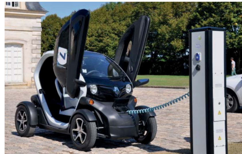
Borne de recharge électrique, Saintronic
